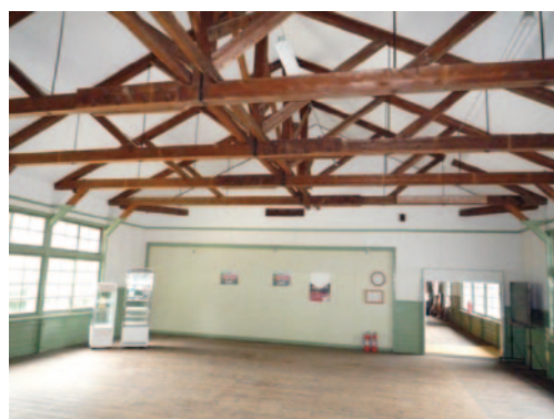
古い木造学校校舎（外観、熊本県小国町杖立） 講堂兼体育館の内部、小屋組みに意欲が見える
